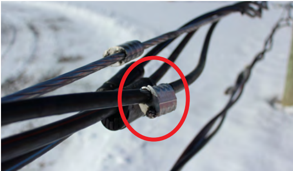
Protecteur manquant sur la connexion
