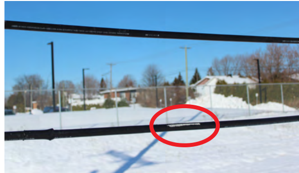
Gaine de conducteur endommagée
